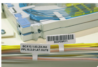
Kennzeichnungen von Glasfaserkabeln
